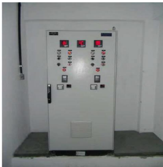
Figura 52 – Quadro de comando da Estação Elevatória EE0.
