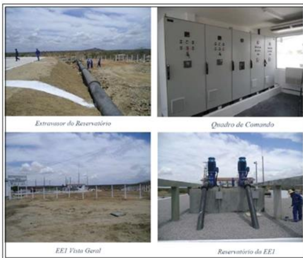
Figura 53 – Equipamentos elétricos da Estação Elevatória EE1.
