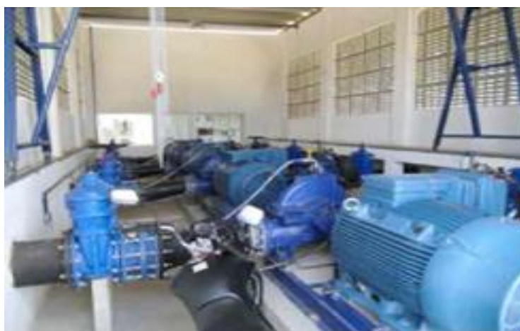
Figura 55 – Equipamentos elétricos da Estação Elevatória EE2.
