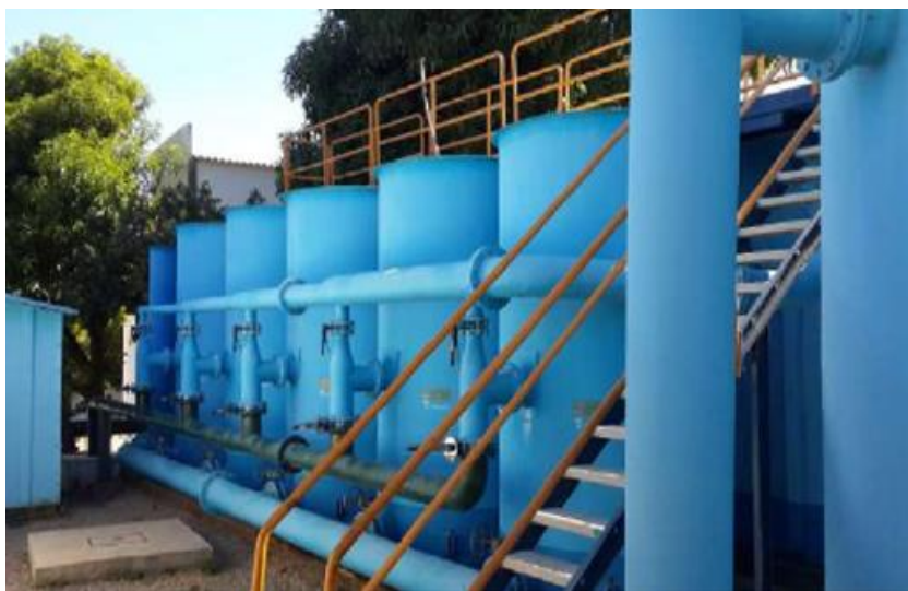
Figura 59 – Unidade de tratamento do tipo convencional/compacta.
