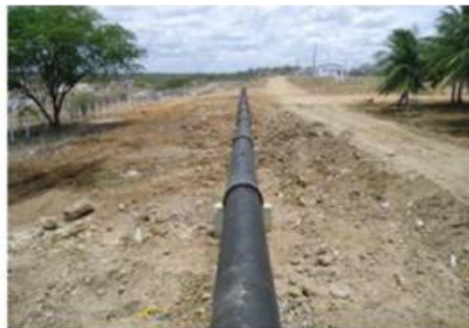
Adutora 600mm que vai para EE1
