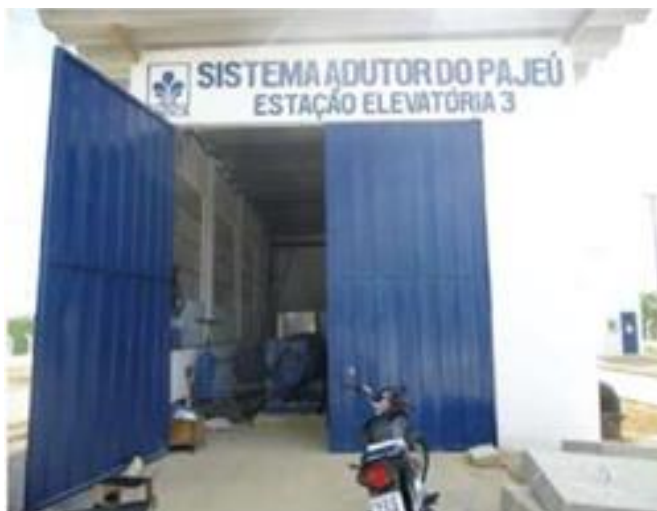
Figura 56 – Vista da Estação Elevatória EE3.
