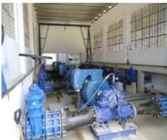
Figura 57 – Equipamentos elétricos da Estação Elevatória EE3.
